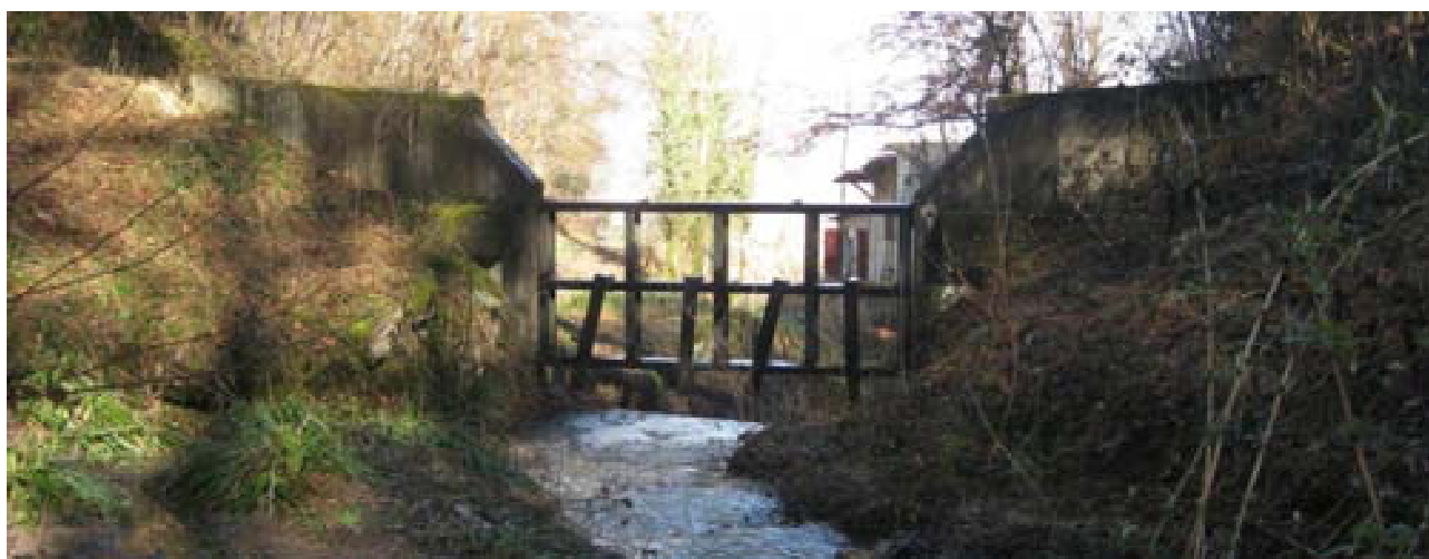
Bassin de piégeage des matériaux du torrent du Rechouchet (source : Alpes-Géo-Conseil)
